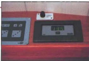
Sul display Vap si legge la tensione della batteria dei servizi, al momento di 13,5 V.
